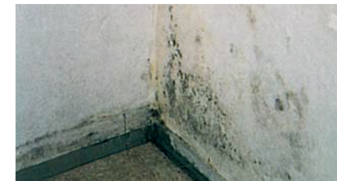
Przykład degradacji ściany
