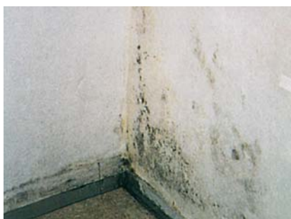
Exemple de dégradation d'une paroi
