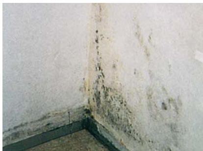
Příklad následků tepelného mostu
