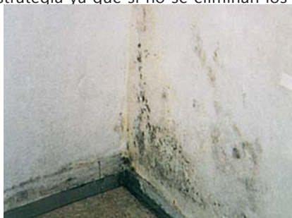
Ejemplo de Degradación de un muro.
