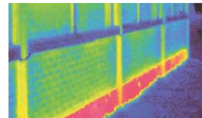
Przykład mostka termicznego u podłoża ściany
