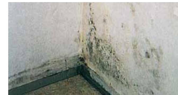
Przykład degradacji ściany
