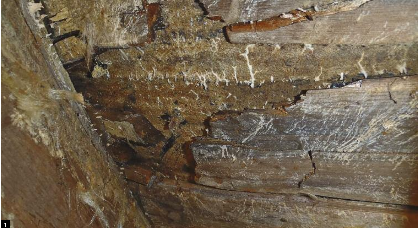
1 Pourrissement du bois après rénovation d'une toiture, Photographie : Ing. Peter Borgers, Bureau Bouwpathologie BB pour www.bouwwereld.nl
