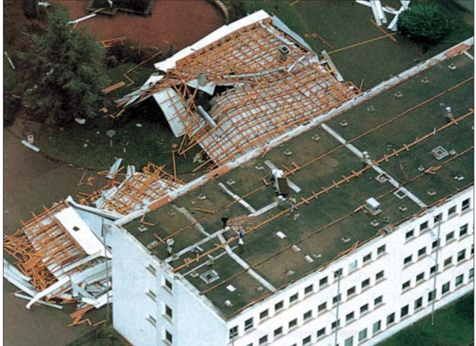
Las imágenes dan una idea de la carga de viento que aguantaron las cubiertas con chapas metálicas FOAMGLAS® durante el huracán de 1999 que azotó a Europa Occidental y Central.
