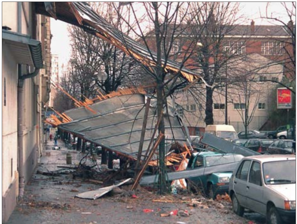
Numerosas cubiertas metálicas ventiladas fijadas sobre listones fueron arrancadas de cuajo – incluso las cubiertas (foto más arriba) no soportaron los efectos del huracán.
