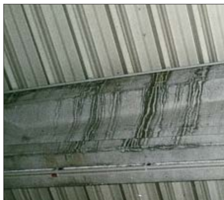
Humedad cayendo de la cubierta, restringiendo el uso de las instalaciones.
