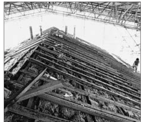
Componentes de cubiertas en descomposición. Trabajo de rehabilitación oneroso bajo una protección provisional contra la intemperie.
