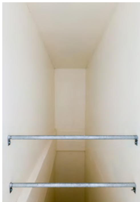
Luchtkanalen gemaakt uit onbrandbare FOAMGLAS®-materialen met een PC® 74 A2-coating.
