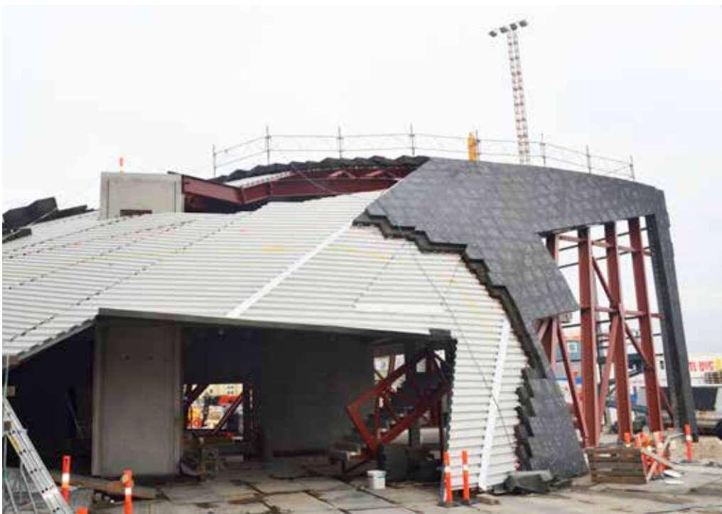
Isolering av fasade kledd med plater. Musikkens hus i Århus i Danmark.
