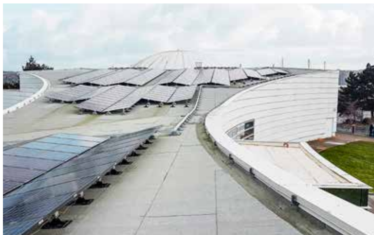
Fotovoltaïsche daken Océanopolis, Brest, Frankrijk
